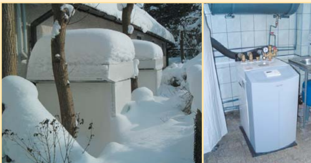
Pompy ciepła WPL w kaskadzie
