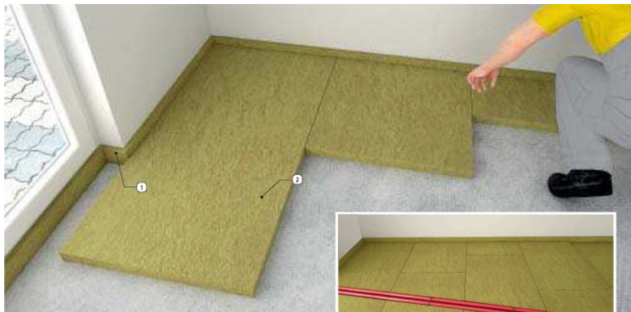
Rys. 4.2.1. Zastosowanie wełny szklanej ISOVER TDPT o grubości 1,5 cm do wykonania pasów dylatacji obwodowej (1) oraz izolacji podłogi z płyt wełny szklanej ISOVER TDPT lub wełny skalnej Stropoterm (2)
