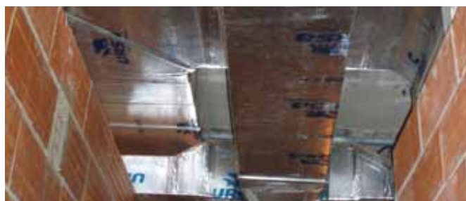
Zdjęcie nr 1 • Powierzchnia zewnętrzna zmontowanej i zainstalowanej sieci przewodów. Na fotografii widoczne są także logo producenta i oznaczenie produktu.
