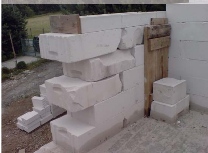
Rys. 2. Skrajny przykład braku selekcji wbudowywanych elementów murowych
