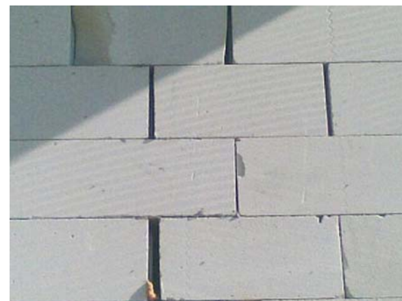
Rys. 3. Nieprecyzyjne ułożenie elementów murowych to częsty efekt braku dokładności wykonawcy
