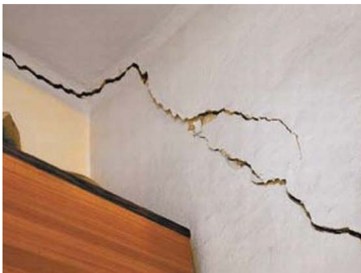
Rys. 4. Ugięcie stropu oraz niedostateczna dylatacja połączenia ze ścianką działową mogą powodować znaczne szkody
