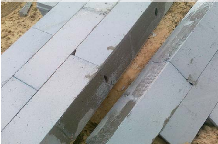
Rys. 1. Fragment muru ściany szczytowej zniszczonego podmuchem wiatru – przyczyną awarii było zastosowanie zaprawy do cienkich spoin niekompatybilnej z bloczkami z betonu komórkowego
