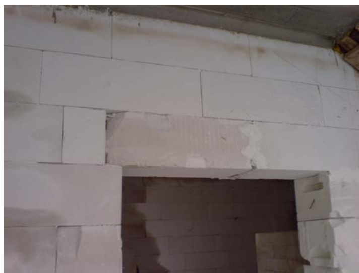
Rys. 5. Nadproże wykonane przez samo klejenie bloczków na zaprawie murarskiej. Brak zbrojenia oraz mała szerokość oparcia nadproża stanowi zagrożenie dla użytkowników budynku
