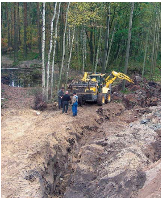
▲ Prace związane z zakopaniem kolektora płaskiego wymagały dużej sprawności od operatora koparki oraz całej ekipy
