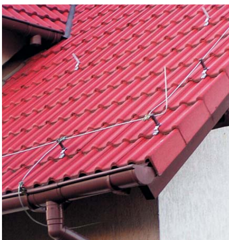
▲ Instalacja odgromowa z przewodów metalowych – jej układ uzależniony jest od kształtu dachu i materiału z jakiego jest wykonane jego pokrycie
