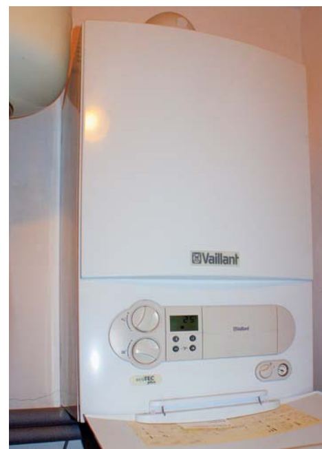
▲ Ciepło w domu zapewnia kocioł kondensacyjny
