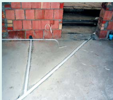
Odcinki pionowe najczęściej układa się w brzdach ściennych, poziome natomiast w grubej warstwie wylewki
