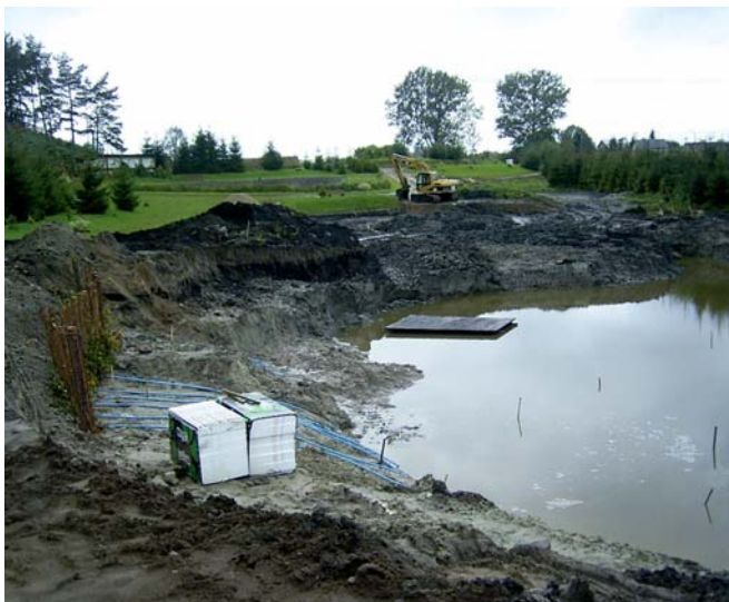
▲ Staw wypelniający się wodą. Widoczne są końce poszczególnych pętli biegnące w kierunku zakopanej w ziemi studzienki zbiorczej
