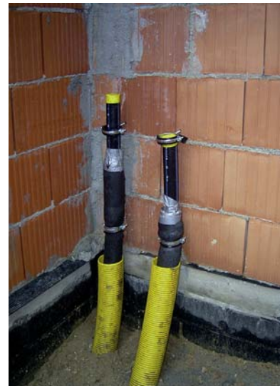
▲ Wyloty rur przesyłu – miejsce, w którym będzie stała pompa ciepła
