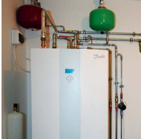
10 Pompa ciepła firmy Danfoss DHP-C 8 o mocy 8 kW. Jednostka ta jest wyposażona w zbiornik ciepłej wody użytkowej o pojemności 180 litrów (z bardzo wydajną wężownicą) oraz moduł chłodzenia pasywnego. Latem ciepło odbierane z posadzki jest przekazywane do dolnego źródła i niejako „ładuje” je na kolejny sezon. Podłużny element z tworzywa po lewej stronie to zbiornik wyrównawczy dolnego źródła, który zapewnia stałe ciśnienie roztworu glikolowego w układzie. Czerwony zbiornik nad pompą, to naczynie przeponowe centralnego ogrzewania, zielone – ciepłej wody użytkowej. Rury ogrzewania należą do systemu SANHATerm, który jest systemem zaciskowym
