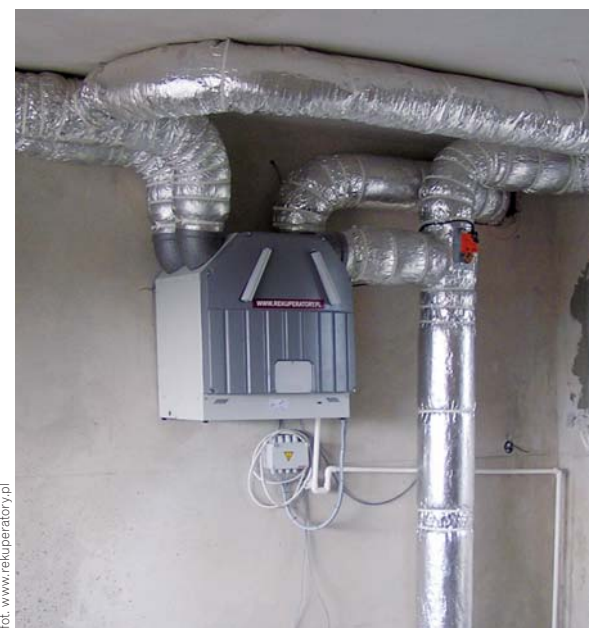
▲ Rekuperator najczęściej montuje się na poddaszu, w pomieszczeniu gospodarczym na parterze lub w garażu
