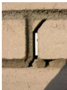
Zamiast wapna zastosowano w zaprawie cementowej plastyfikator (domieszkę napowietrzającą)
