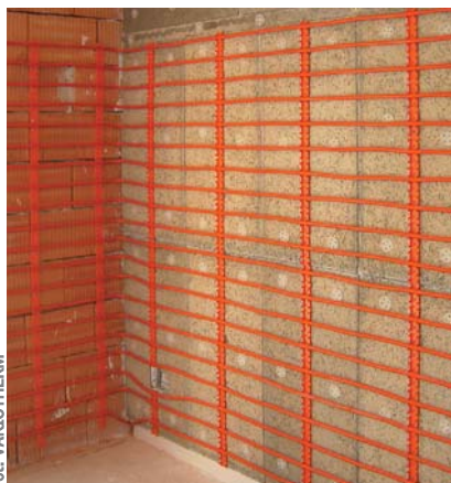
Instalacje ogrzewania płaszczyznowego czasem układa się na ścianach ▲
