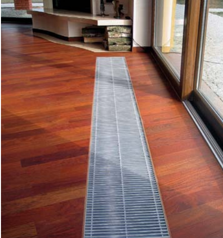
Grzejniki kanałowe umieszczone w pobliżu drzwi tarasowych tworzą skuteczną barierę przeciwko wdzieraniu się chłodnego powietrza w głąb pomieszczenia
