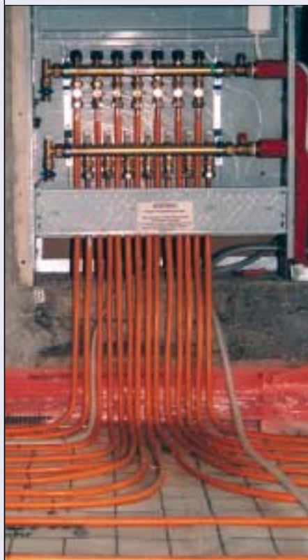
11 Szafka z rozdzielaczami (fot. Wieland Polska)
