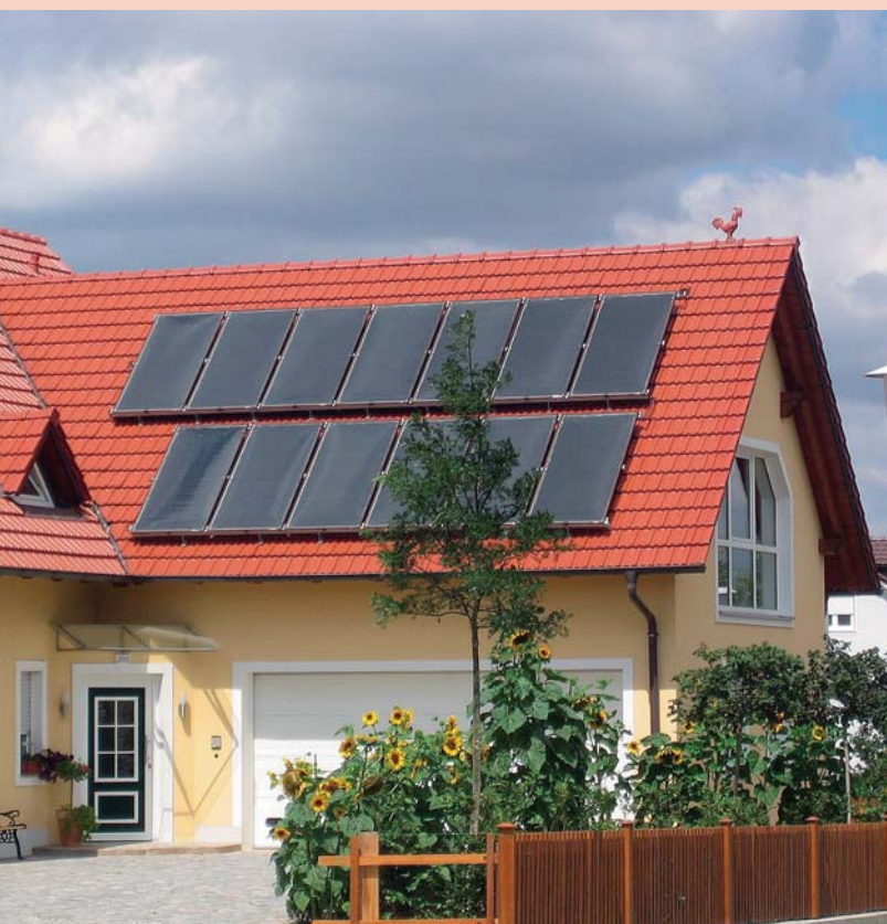
▲ Kolektory słoneczne do zasilania c.w.u. zainstalowane na dachu budynku mieszkalnego
