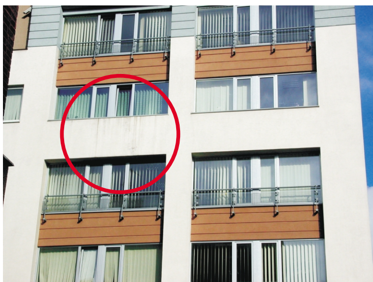
Zdjęcie Nr 1. Przykład źle osadzonej stolarki okiennej. Zbyt małe odsunięcie okapnika od płaszczyzny elewacji powoduje brudny zaciek poniżej - usterka taka może być zauważona na elewacji w ciągu kilku tygodni po wykonaniu elewacji i szybko usunięta w ramach rękojmi przez wykonawcę elewacji
