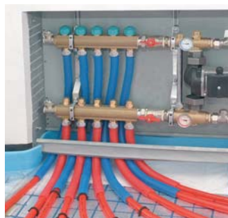
Rozdzielacz do ogrzewania wodnego, zamontowany w szafce podtynkowej
