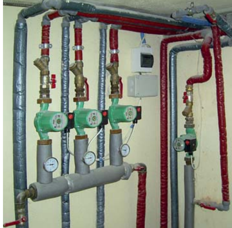
▲ Maty kapilarne na każdym piętrze są obsługiwane przez jedną pompę obiegową. Pozwala to na swobodne regulowanie temperaturą w poszczególnych częściach domu. Ogrzewanie grzejnikowe w piwnicy ma natomiast osobną pompę
