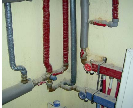
▲ Rozdzielacze znajdujące się w piwnicy dzielą czynnik grzewczy na poszczególne piętra (w zależności od zapotrzebowania)
