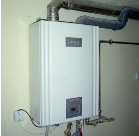
▲ W domu Magdy i Rafała źródłem ciepła jest kocioł kondensacyjny, ale cała instalacja jest wykonana w taki sposób, że w każdej chwili może on być zamieniony na pompę ciepła
