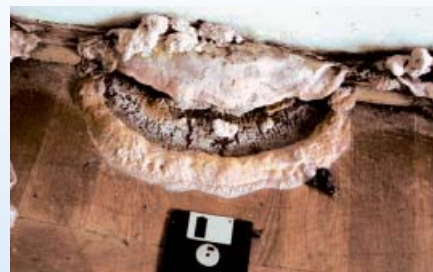
Zbyt duża wilgotność w pomieszczeniu zaowocować może rozwojem szkodliwego grzyba lub pleśni (fot. Ekono)
