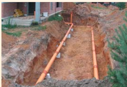
Tak wygląda wymiennik gruntowy w praktyce (fot. Emka Wentylatory)
