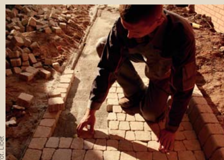
▲ Następnie układa się kostkę brukową, dobijając każdy element młotkiem gumowym. Nawierzchnię należy układać od brzegu ku środkowi, aby nie niszczyć już przygotowanej podbudowy. Szczeliny w nawierzchni z kostki betonowej wypełnia się piaskiem z wodą, a między kostkami kamiennymi – zasypką granitową. Na koniec kostkę dobija się do podłoża wibratorem powierzchniowym
