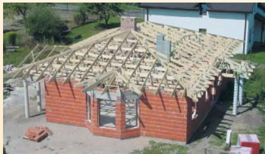
Drewno do budowy więźby dachowej najlepiej jednak kupować w firmie, która dostarczy materiał odpowiednio przycięty, zaimpregnowany i wysuszony (fot. Mabudo)
