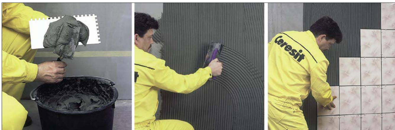
10 Etapy układania ceramicznych płytek ściennych: nałożenie zaprawy na gładką stronę pacy zębatej i rozsmarowanie jej na ścianie; przegarnięcie stroną ząbkowaną; dociśnięcie płytki, właściwy odstęp od poprzednio ułożonej pozwalają zachować krzyżyki odległościowe (fot. Henkel Bautechnik)
