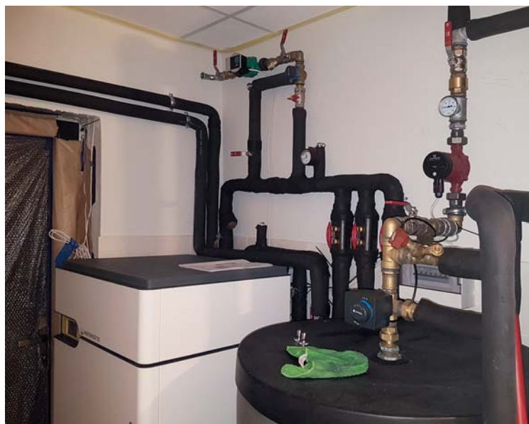
Kotłownia w „Domu słonecznym”. Źródło: Pasywny m 2 .
