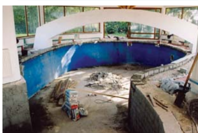
Basen przed remontem
