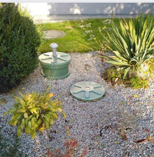
Skrzynka techniczna i pokrywa zbiornika
