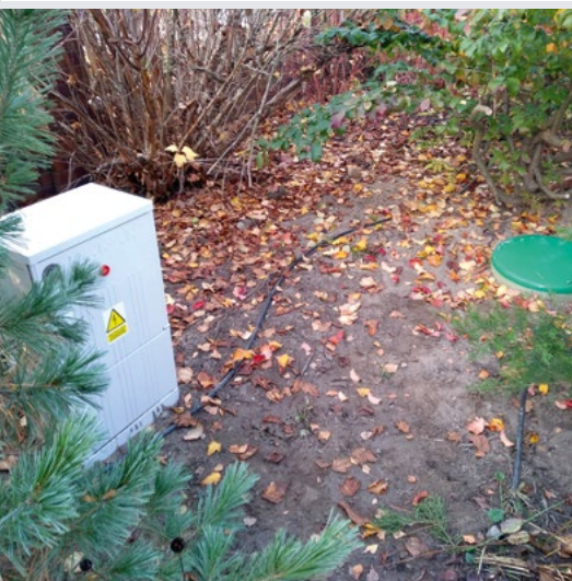
Skrzynka techniczna i pokrywa zbiornika
