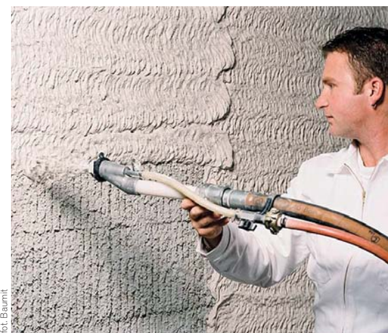
▲ Wykańczanie ścian tynkiem maszynowym. Przy dużej powierzchni wykorzystanie agregatu tynkarskiego zdecydowanie przyspiesza pracę
