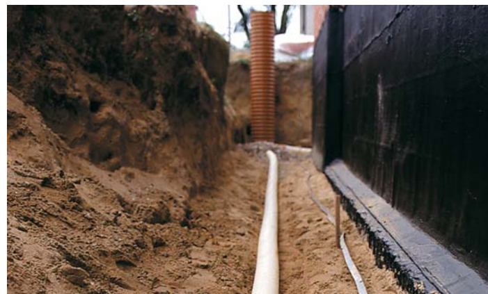
▲ Drenaż opaskowy budynku jest konieczny w prawie każdym gruncie gliniastych i to niezależnie od poziomu wody gruntowej
