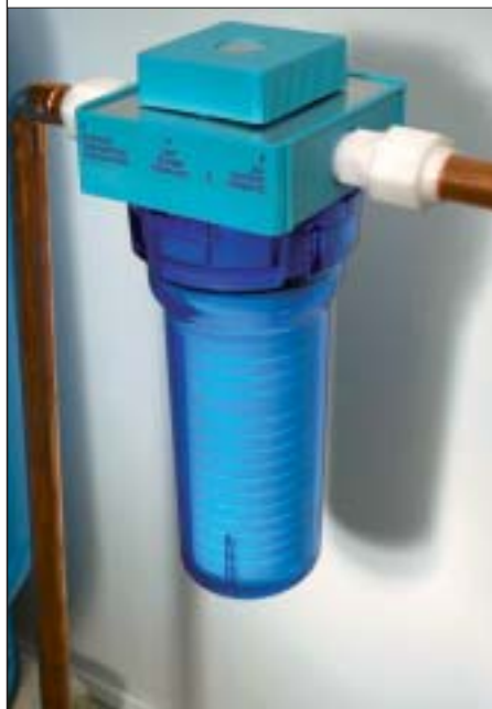
1 Filtr zamontowany na instalacji wodnej (fot. Ekonet)
