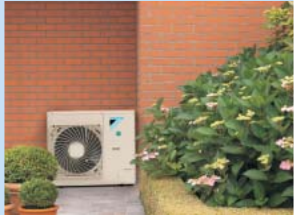
3 Jednostka zewnętrzna ulokowana przy ścianie budynku (fot. Daikin Poland)
