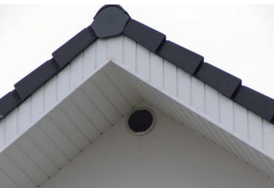
▲ Czerpnia ścienna zamontowana pod szczytem dachu
