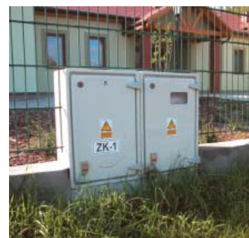
Skrzynkę elektryczną z licznikiem umieszcza się zazwyczaj w linii ogrodzenia (fot. archiwum BD)
