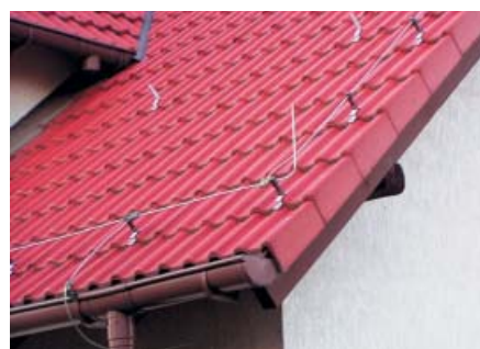
Instalacja odgromowa na dachu budynku (fot. Błyskawica)
