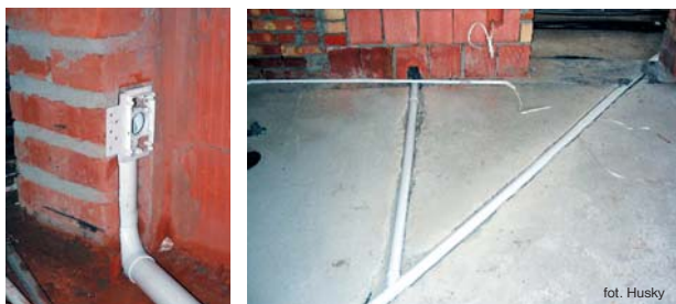
Odcinki pionowe najczęściej układa się w bruzdach ściennych, poziome natomiast w grubej warstwie wylewki
