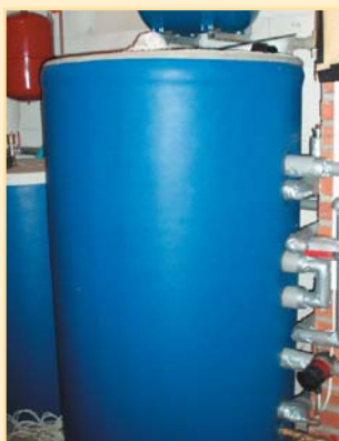
Dużą powierzchnię kotłowni zajmuje 500-litrowy zbiornik c.w.u. (z przodu) oraz zbiornik buforowy 200 l
