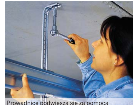
Prowadnice podwiesza się za pomocą wcześniej zamocowanego uchwyty. Dyble i śruby wkręca się do stropu. W ten sposób wykonuje się i usztywnia konstrukcję bramy
