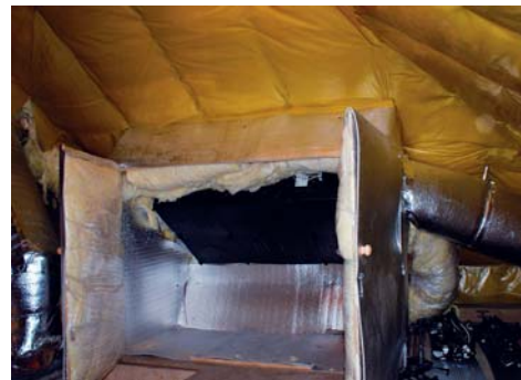
▲ Centrala wentylacyjna znajduje się w pomieszczeniu na poddaszu
