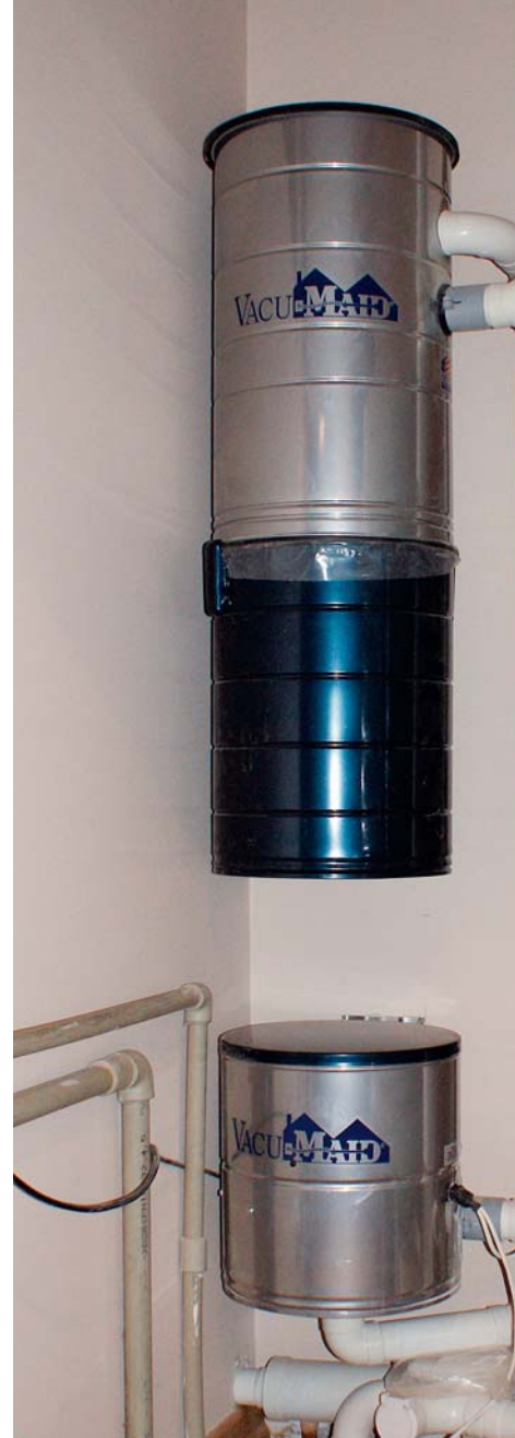
▲ Odkurzacz centralny typu split zamontowany został w pomieszczeniu technicznym na parterze
