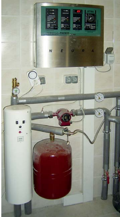
▲ Elektryczny kocioł EKW (biały, walcowaty element) zapewnia minimalny komfort cieplny w domu (zabezpiecza instalację grzewczą przed zamarznięciem) w przypadku awarii pompy ciepła
