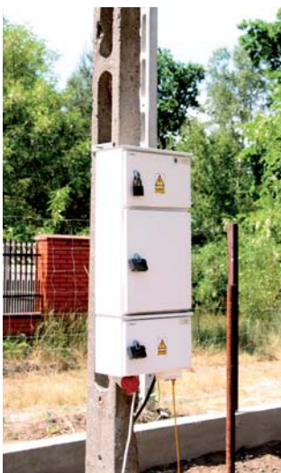
Skrzynkę elektryczną z licznikiem najczęściej umieszcza się w linii ogrodzenia
