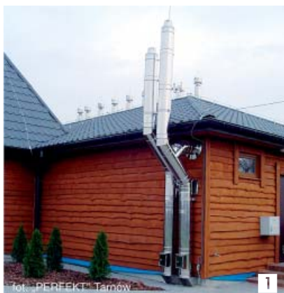
Stalowe kominy poprowadzone na zewnątrz 1 i wewnątrz budynku 2
