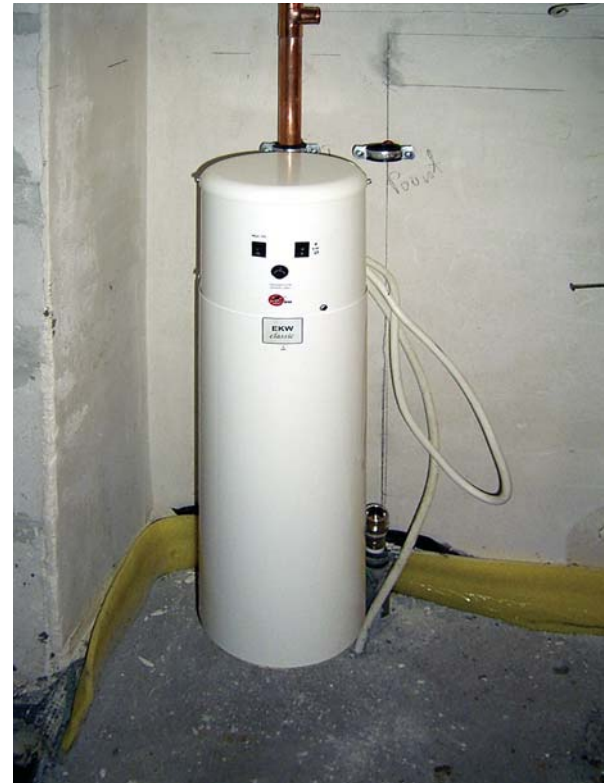
▲ Elektryczny kocioł EKW zapewnia minimalny komfort cieplny w domu (zabezpiecza instalację grzewczą przed zamarznięciem) w przypadku awarii pompy ciepła
