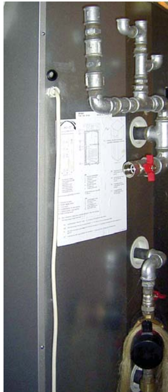
▲ Przed podłączeniem podgrzewacza c.w.u. trzeba zamontować naczynie wzbiorcze, zawór bezpieczeństwa i pompę obiegową
