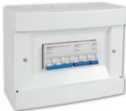
1 Skrzynka rozdzielcza (foto. Elda-Eltra)
