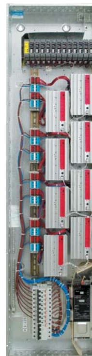
6 W tym systemie wszystkie obwody zbiegają się w rozdzielniczy (fot. Lutron Europe) ▲
