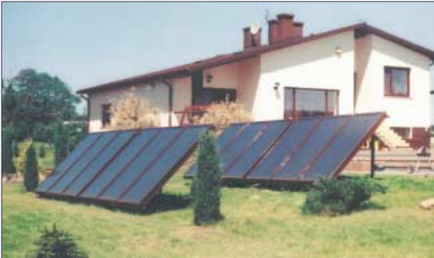
8 Kolektory przed budynkiem (fot. Aparel)
