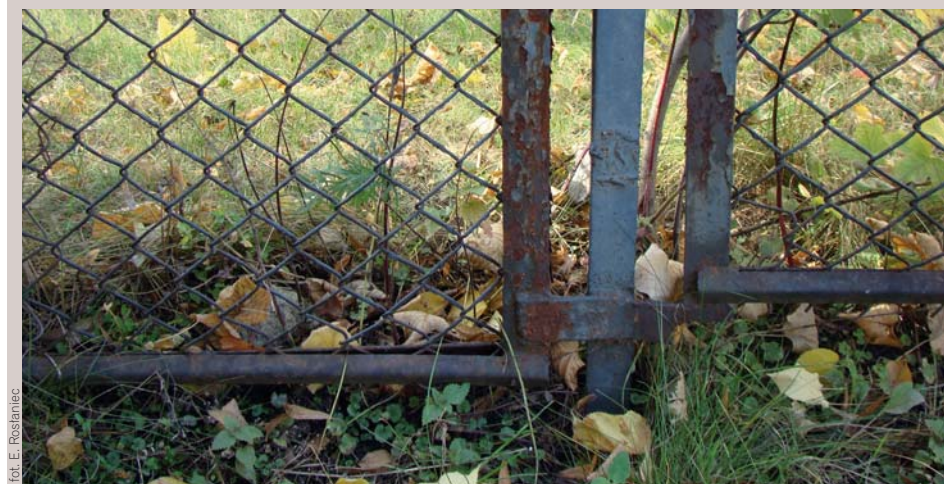
▲ Stalową siatkę niezabezpieczoną powłoką antykorozyjną w większości przypadków trzeba będzie wymienić na nową
