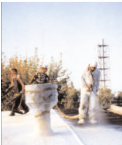
15 Natryskiwanie pianki poliuretanowej na dachu płaskim to czynność nie zajmująca dużo czasu (fot. Zakłady Przetwórstwa Tworzyw Sztucznych)
