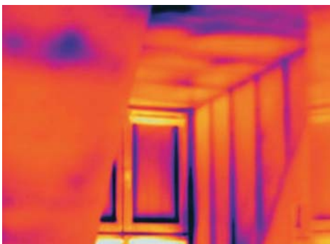
FOT 3. ZDJĘCIE TERMOWIZYJNE PODDASZA OD WEWNĄTRZ. MIEJSCA CIEMNIEJSZEGO KOLORU WSKAZUJĄ NA WYSTĘPOWANIE MOSTKÓW LINIOWYCH WYNIKAJĄCYCH Z NIEPRAWIDŁOWEJ KONSTRUKCJI I MONTAŻU IZOLACJI W POŁĄCZENIU DACHU. KONIECZNE PRZEKONSTRUOWANIE DACHU ORAZ ZWIĘKSZENIE GRUBOŚCI OCIEPLENIA
