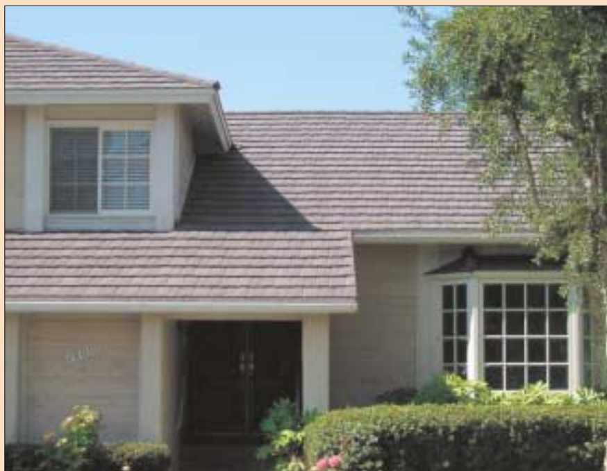
5 Blachodachówka z posypką (fot. Tuplex)
