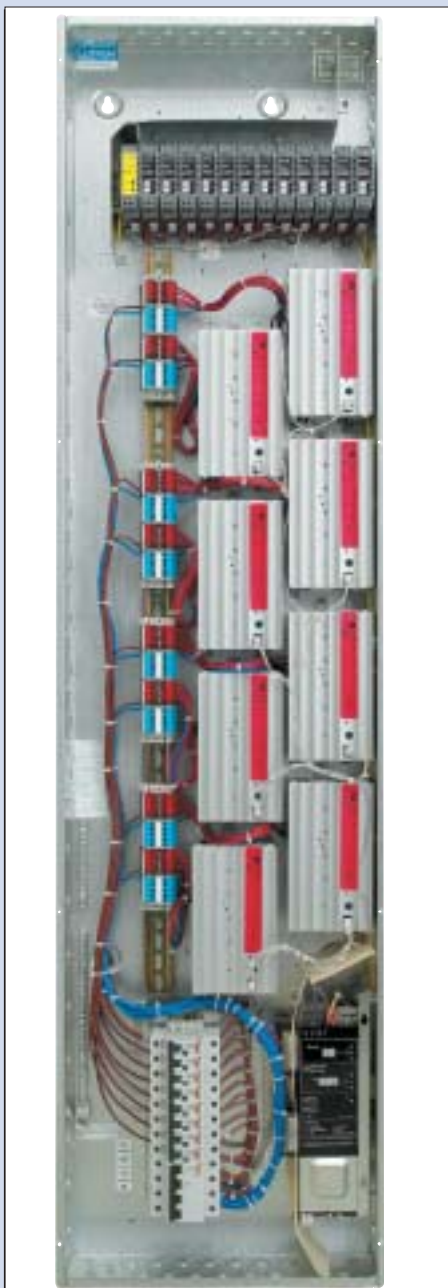
5 Tak złożona rozdzielnica zawiera wszystkie systemowe elementy wykonawcze a także procesor zarządzający funkcjonowaniem całości (fot. Lutron Europe)
