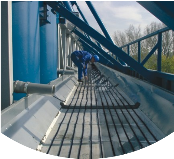
Mocowanie przewodów w korycie dachowym
