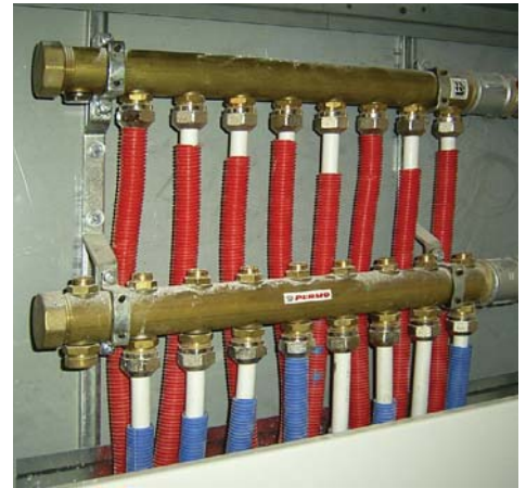
▲ Grzejniki w poszczególnych pomieszczeniach są zasilane niezależnie dzięki rozdzielaczowi. Czerwone końcówki – zasilanie, niebieskie – powrót
